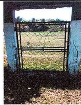
Foto 4: en la imagen se evidencia las condiciones del porton secundario de ingreso al establecimiento.
