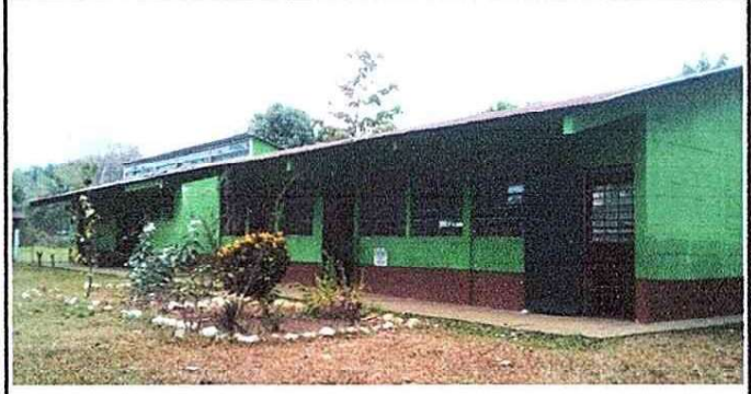
Foto 2: en la imagen se evidencia los dos edificios que necesitan sustitución de lamina.
