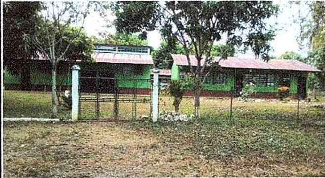
Foto 1: en la imagen se ve el deterioro de las laminas de los dos edificios del centro educativo
