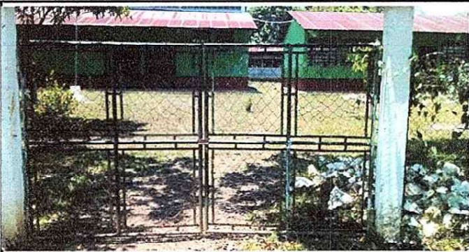
Foto 3: la imagen evidencia la condición del porton del establecimiento.
